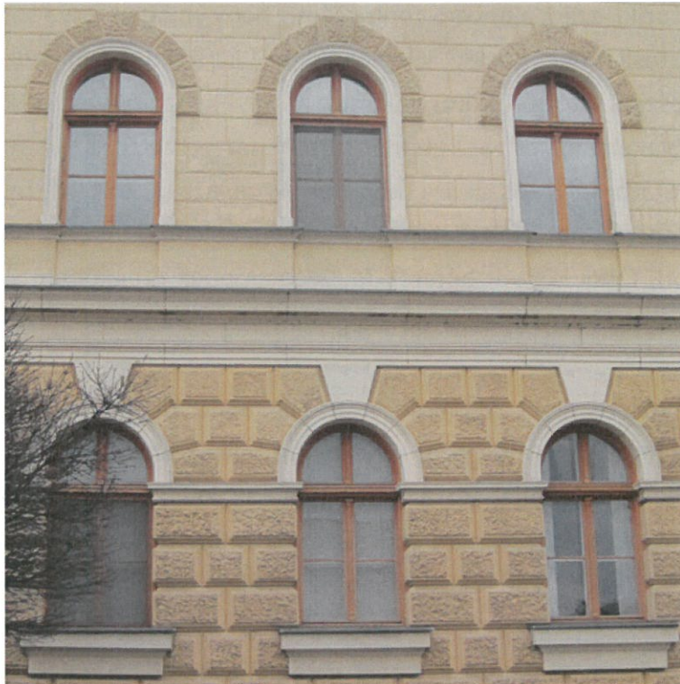
Az emeleti kiállítótermek ablakai a fóliázás után szintén erősebb tükröződést mutatnak a földszinti ablakokhoz képest, de a különbség alig érzékelhető
